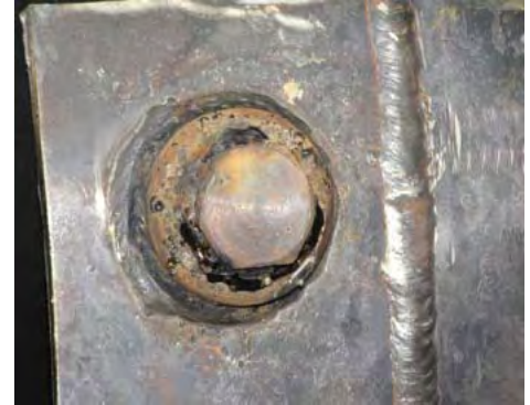
Несанкционированная врезка в нефтепровод.
