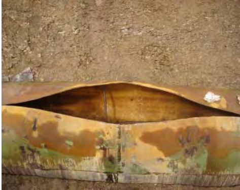
Разрыв нефтепровода вследствие гидравлического удара.
