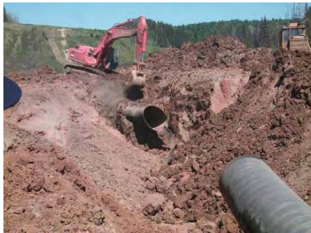
Разрыв трубопровода из-за действия статических нагрузок и внутреннего давления.
